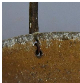
Figure 11 : détail du système d'accroche défaillant
