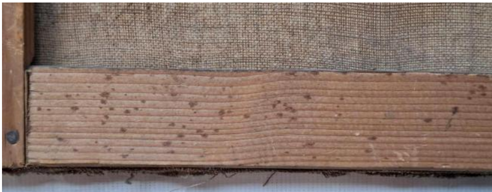
Traces de moisissures sur le montant inférieur
