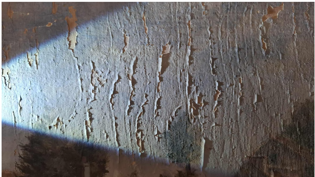
Détails des soulèvements du ciel, lumière rasante
