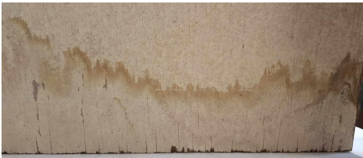
Trace d'auréole sur tout le bas du panneau, et encrassement généralisé
