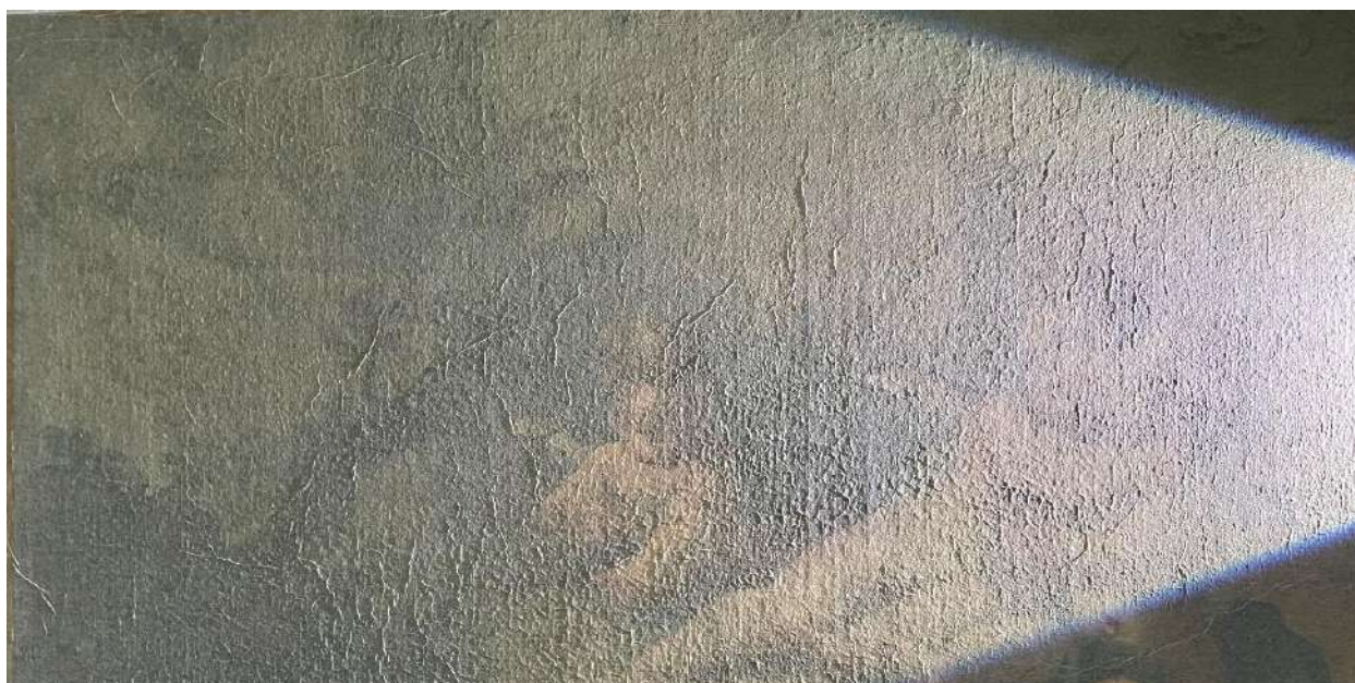
Vue de la face en lumière rasante, mettant en évidence les soulèvements
