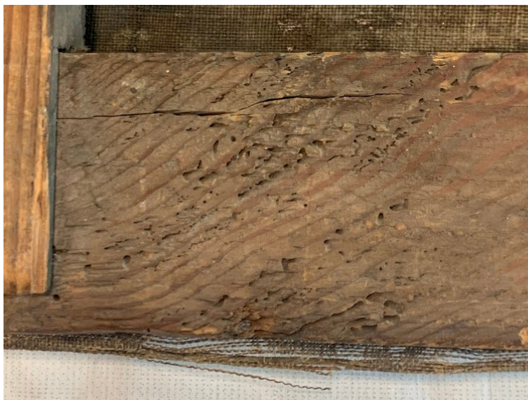
photographie du montant inférieur du châssis : galeries d'insectes rabotées
