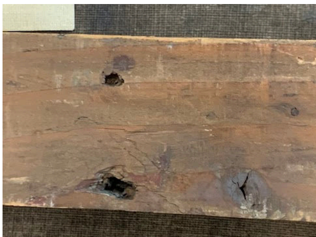
montant centrale partie senestre : anciennes traces de fixation possibles
